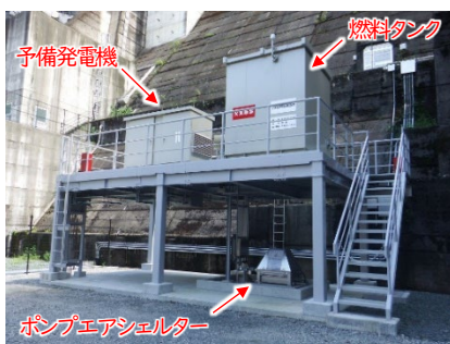
【 予備発電機設備：同敷地内 】
