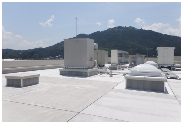
④ 非常用発電機等の機器類は屋上に設置
